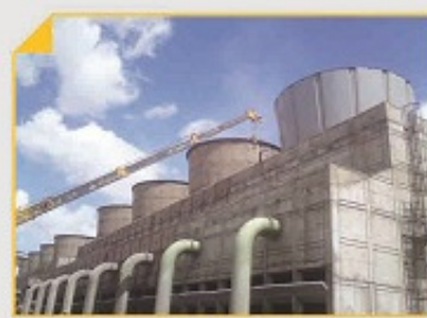
فولاد مبارکه (واحد نیروگاه)
